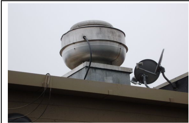
Terminating Exhaust Fan
